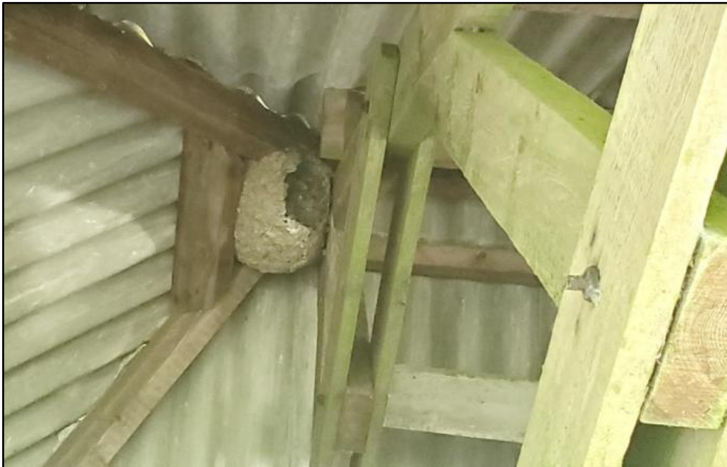
Figure 14 : Nid de Frelon observé dans le bâtiment situé dans la partie est de l'aire d'étude (photographie prise sur site - ECR 2023)
